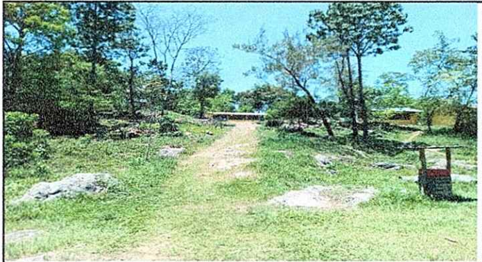
FOTO 1: Entra de la escuela donde se evidencia la falta de muro perimetral
