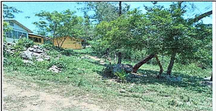
Foto 6: La falta de Muro perimetral permite a que personas ajenas a la comunidad educativa hurte el agua de lluvia que se recolecta
